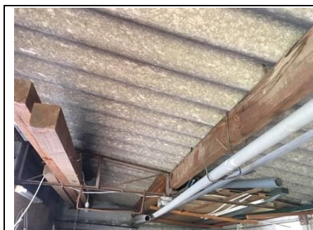
Photo n° PhA002 Localisation : Extérieur - Atelier (présence de mobilier lourd) Ouvrage : Plaques ondulées Partie d'ouvrage : Plaques en fibres-ciment Description : Plaques en fibres-ciment
