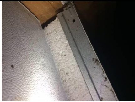
Photo n° PhA003 Localisation : Chai (présence de mobilier lourd) Ouvrage : Flocages, Calorifugeages, Faux plafonds Partie d'ouvrage : Faux plafonds Description : Faux plafonds
